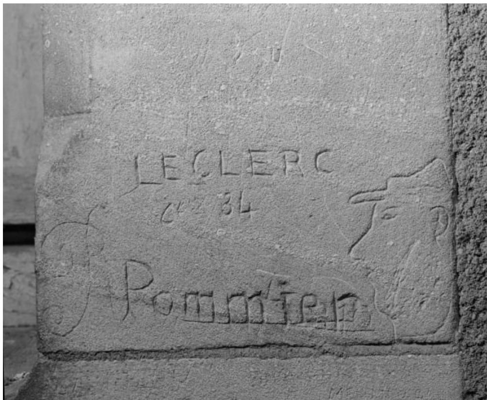
Graffitis sur le chaînage d'angle de la façade postérieure de l'aile militaire du bâtiment principal. 58, Cosne-Cours-sur-Loire, 96 rue du Maréchal-Leclerc
