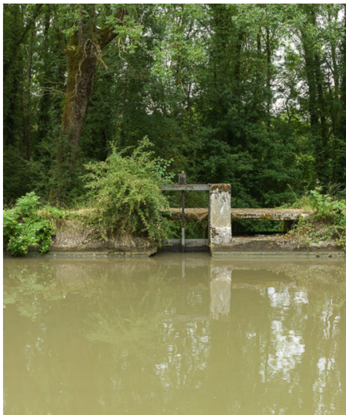
Vue de l'ensemble hydraulique.
