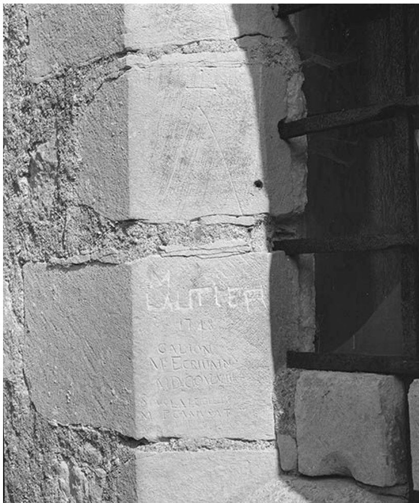
Baie droite du choeur, détail des graffitis.
