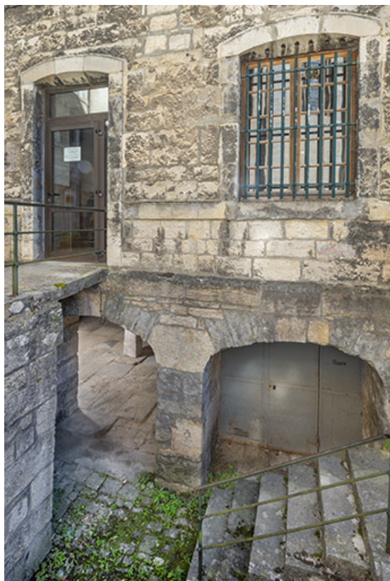
Escalier d'accès aux cellules, depuis la cour ouest. 39, Salins-les-Bains place des Alliés et de la Résistance
