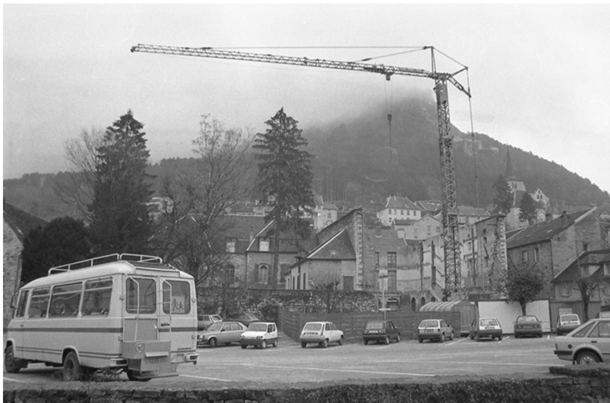
Le théâtre en chantier. Vue depuis la place des Salines, s.d. [1988]. 39, Salins-les-Bains rue de la République
