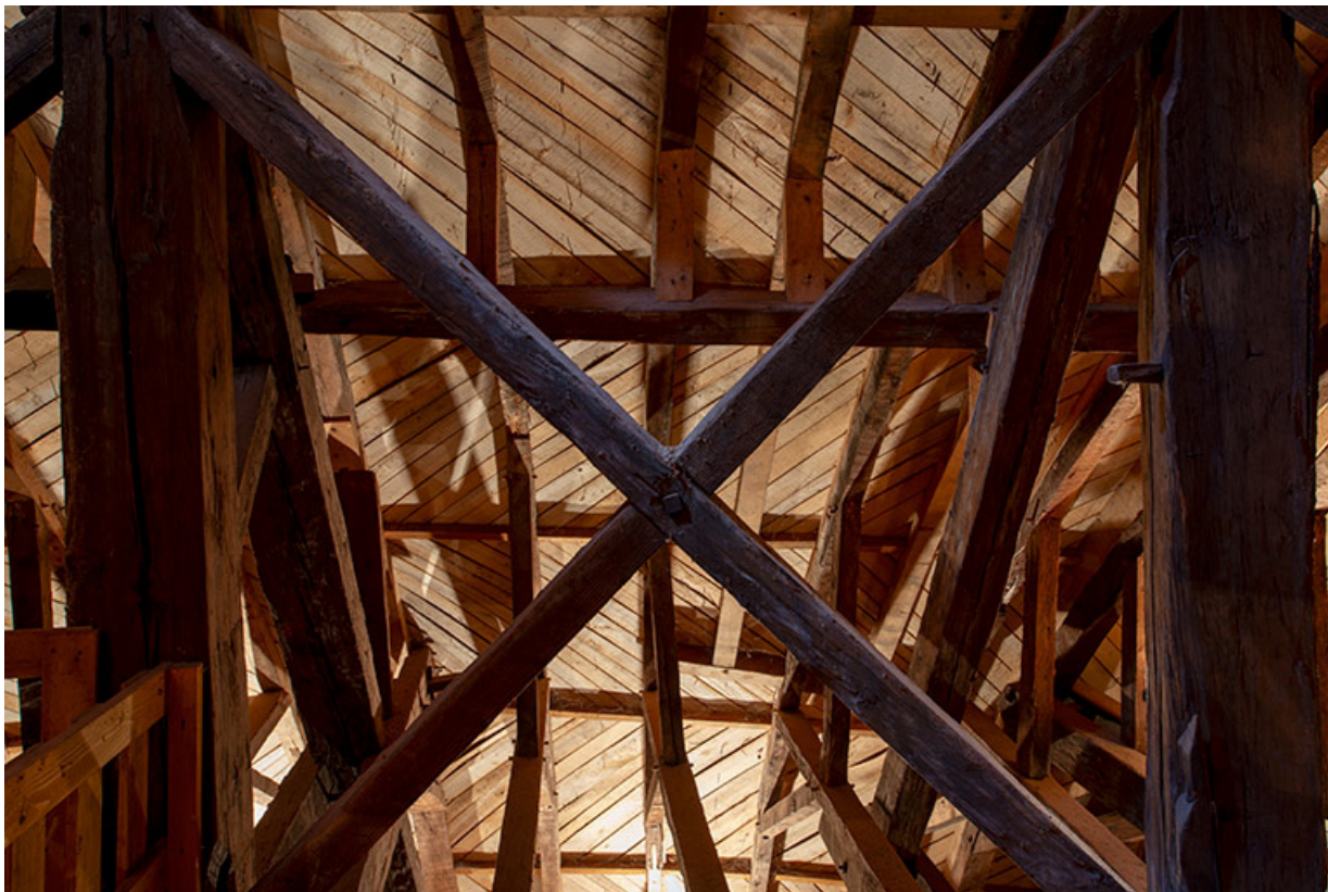
Partie nord depuis le niveau intermédiaire. Entretroise en croix de Saint-André. 39, Salins-les-Bains place des Alliés
