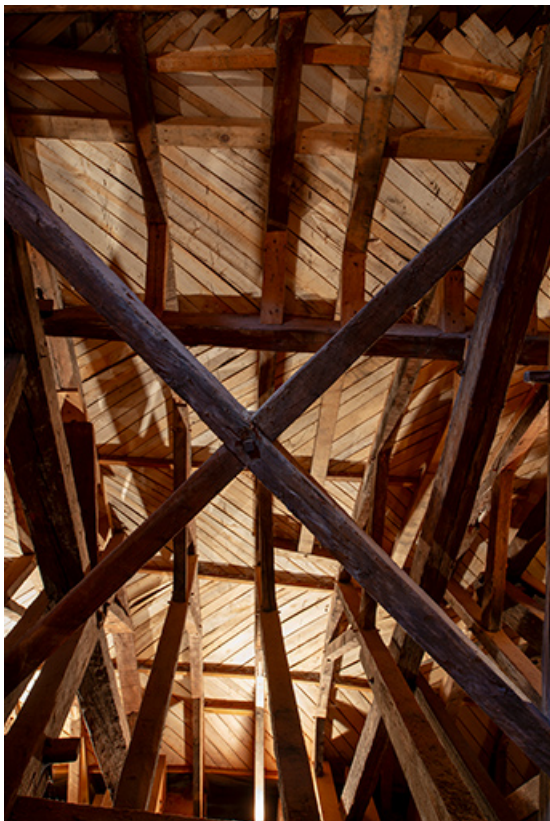
Partie nord depuis le niveau intermédiaire. Entretoise en croix de Saint-André. 39, Salins-les-Bains place des Alliés
