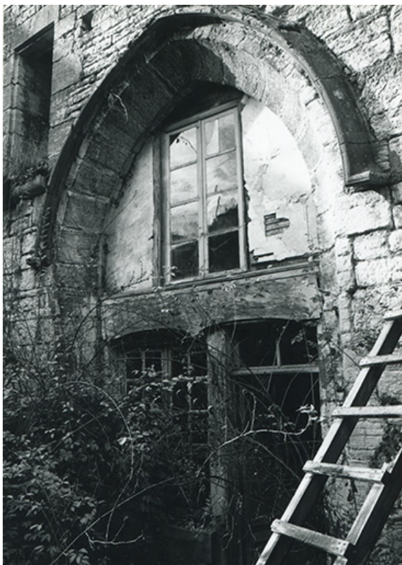
Chapelle. Baie couverte d'un arc en cintre brisé, 1990. 39, Salins-les-Bains, 5, 7 rue du Temple
