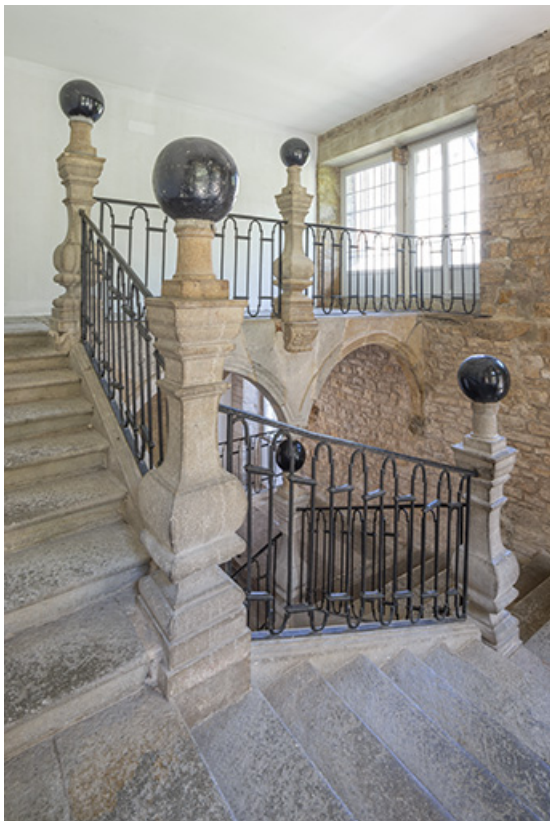
Escalier dit "aux boules de pierre". Vue depuis le troisième palier du premier étage. 39, Salins-les-Bains, 9 rue du Temple
