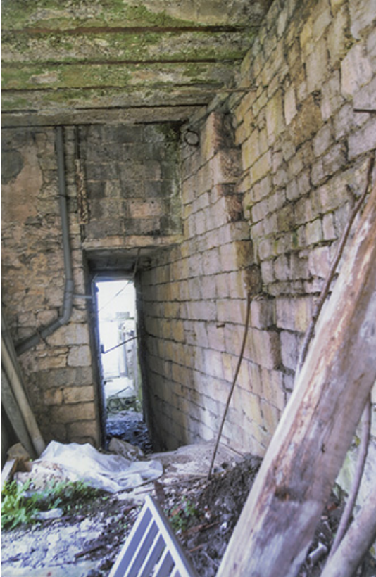
Parement de la courtine nord, rue des Corneux, 2011. 39, Salins-les-Bains
