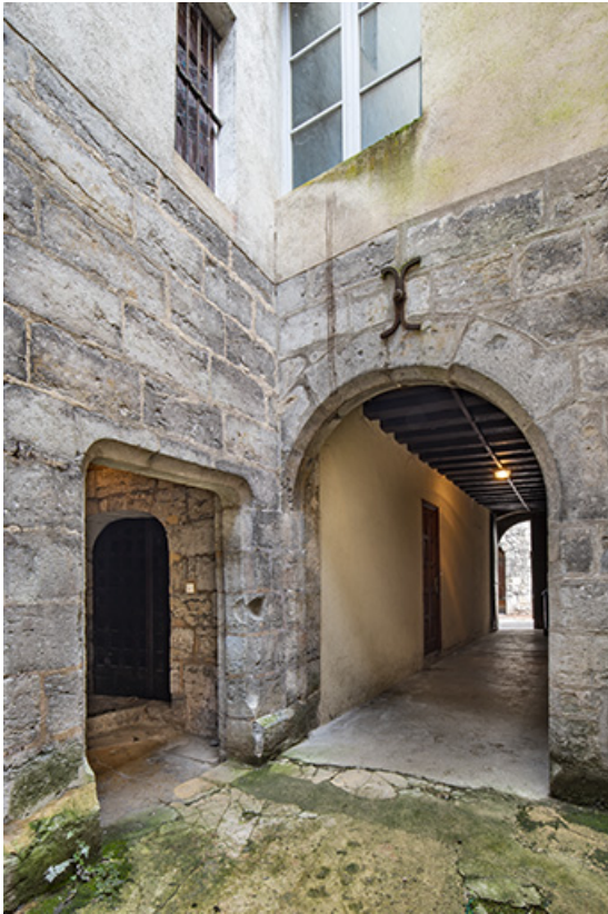
Vue de puis la cour : accès à la tour d'escalier et au couloir d'entrée. 39, Salins-les-Bains, 37 rue de la Liberté
