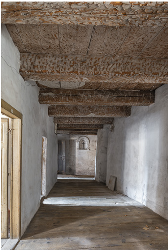
Second étage du bâtiment nord. Le couloir distribuant les cellules des moniales. 39, Salins-les-Bains, 79 rue de la République
