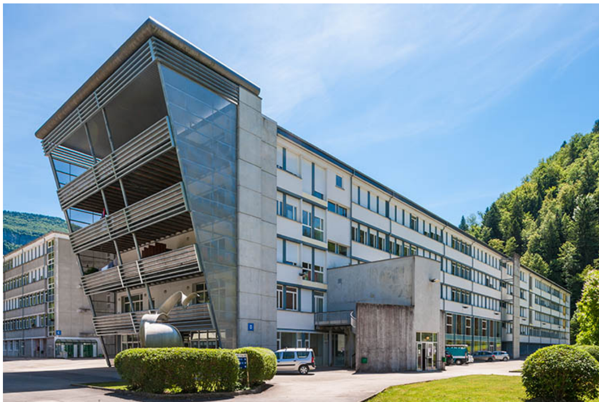
Internat : extension pignon Nord et façade postérieure Ouest. 39, Saint-Claude rue du Tomachon
