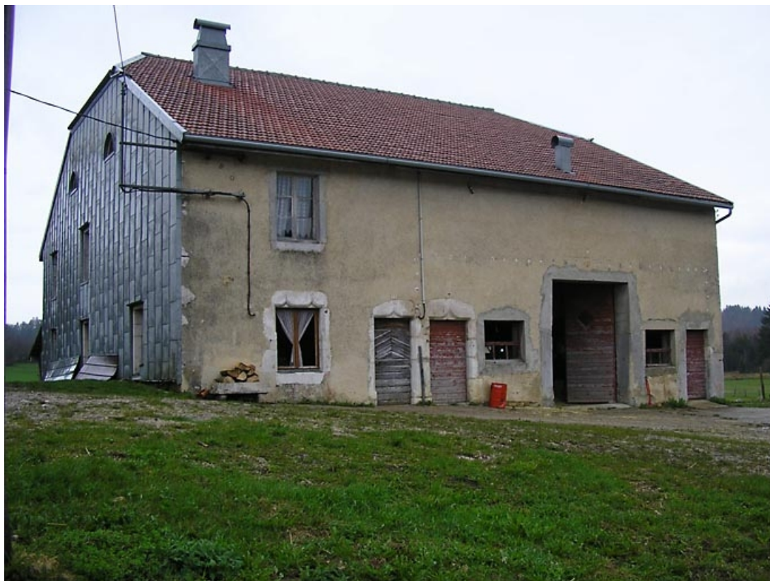
Façade antérieure et pignon sud-ouest vus de trois quarts. 39, Lac-des-Rouges-Truites, 72 les Martins, lieudit : les Martins
