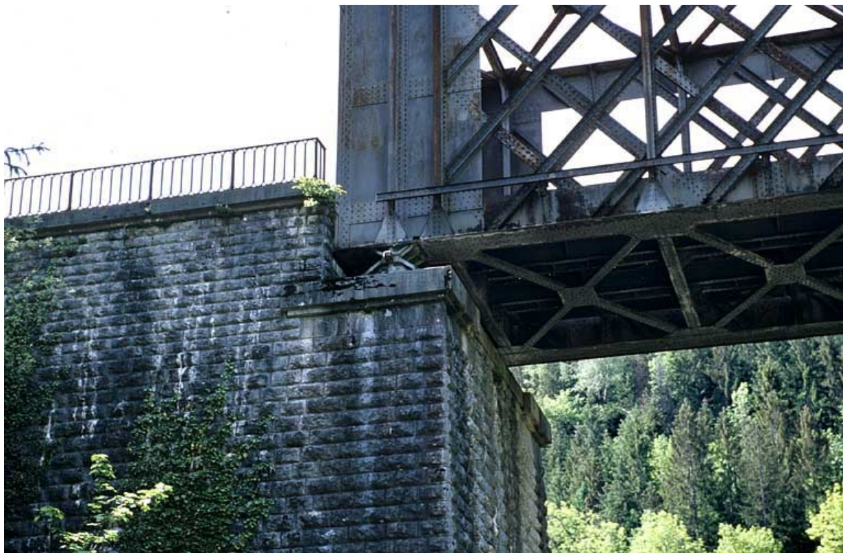
Extrémité côté La Cluse et culée, depuis l'amont : détail montrant l'appui fixe.
