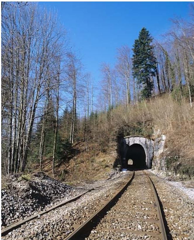
Tunnel des Bataillards : vue d'ensemble rapprochée de la tête côté Andelot-en-Montagne (est). 39, Morbier, lieudit : la Doye de Bienne
