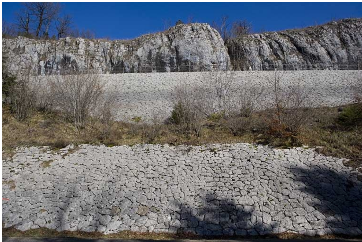
Murs de soutènement (commune de Champagnole), à droite de la voie avant le viaduc de Syam, vus de face. Mur situé entre les PK 017.000 et 018.000, en contre-haut de la R.D. 127.
