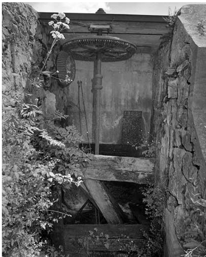
Système de roues hydrauliques, vue générale.
