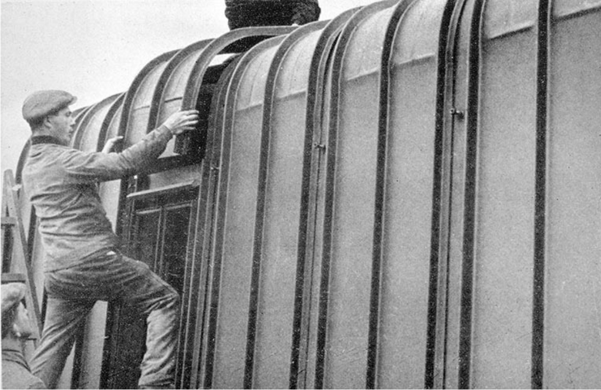
Montage d'un baraquement métallique dans les années 1940 : mise en place d'une tôle du toit. 39, Saint-Amour, 25 rue Lamartine
