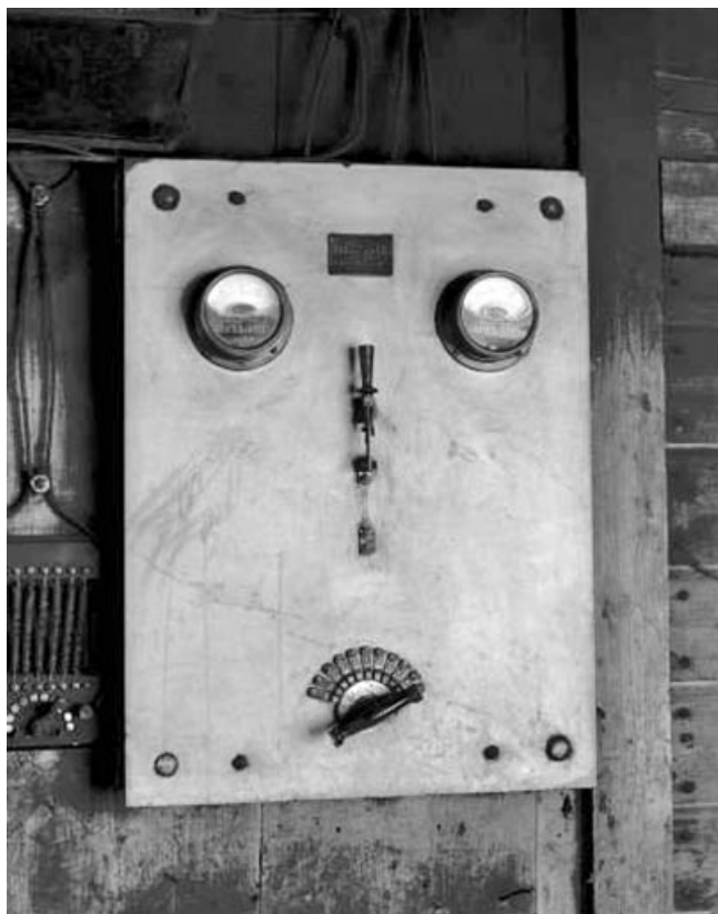
Intérieur : tableau de contrôle Grauer et Weil.
