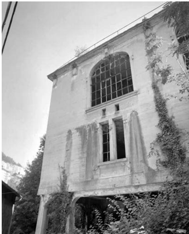
Façade latérale gauche du transformateur : une travée.
