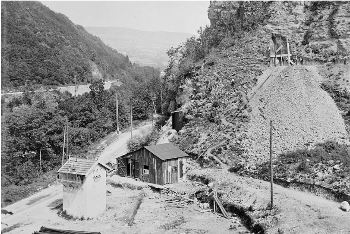
Attaque n° 4. Sortie aval du grand souterrain de 1750 m à Porte-Sachet. Poste de transformation et compression d'air n° 3. 39, Lavans-lès-Saint-Claude
