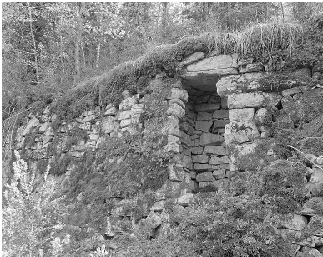
Cabane dans un mur de soutènement, au lieu-dit Sous les Vignes. 39, Ponthoux
