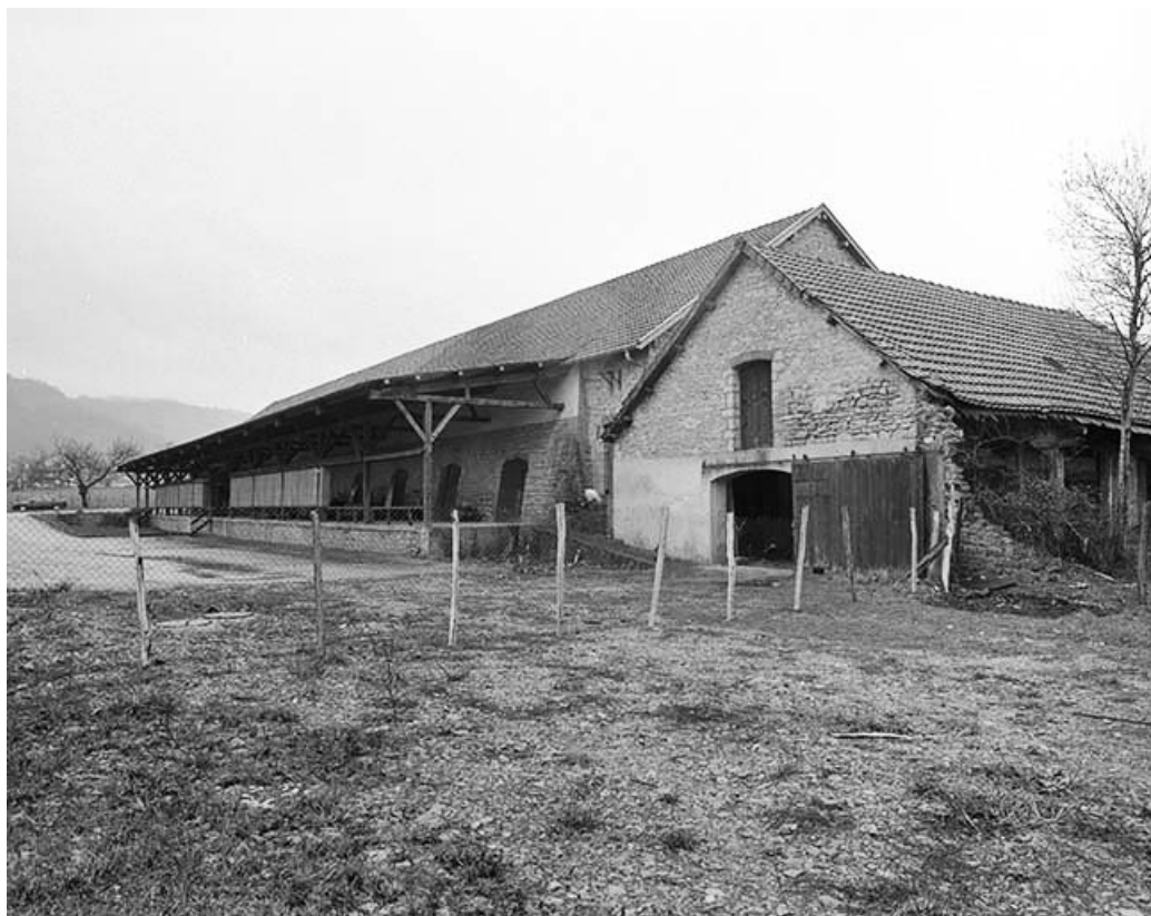
Magasin industriel et atelier de fabrication ruiné.
