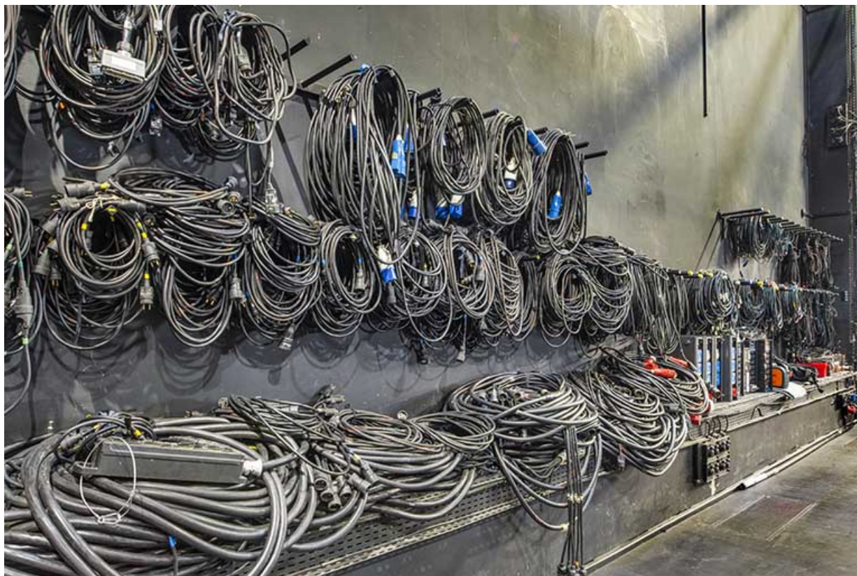
Salle, mur du fond de scène, câbles.
