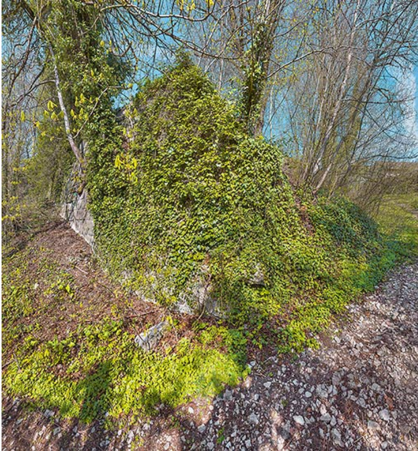
Tronçon de rempart ruiné. 25, Blamont rue Viette
