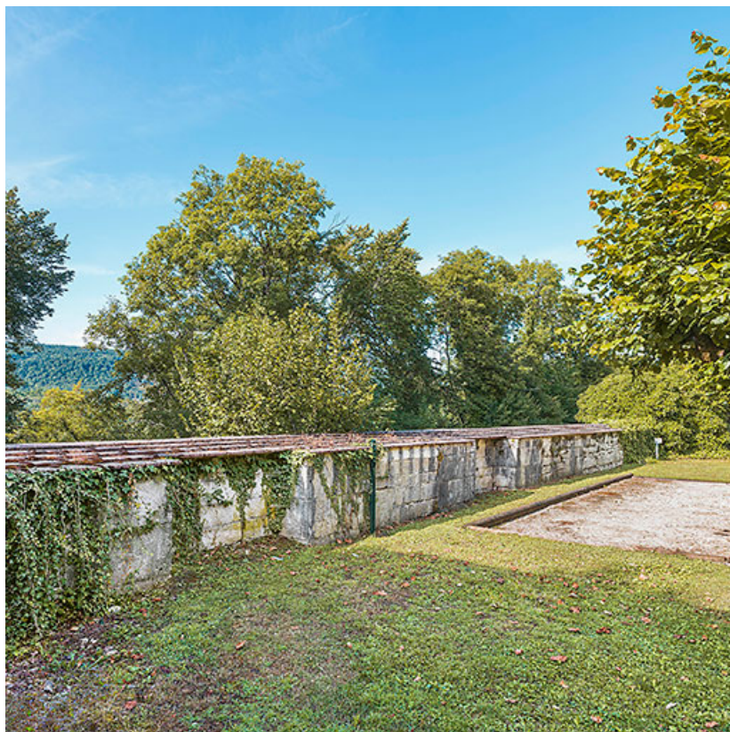
La cortine sud, vue (rapprochée) depuis la cour intérieure. 25, Blamont rue Viette
