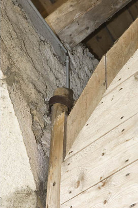
Façade postérieure, porte de grange : gond supérieur du vantail de gauche. 25, Jougne, lieudit : Palzard
