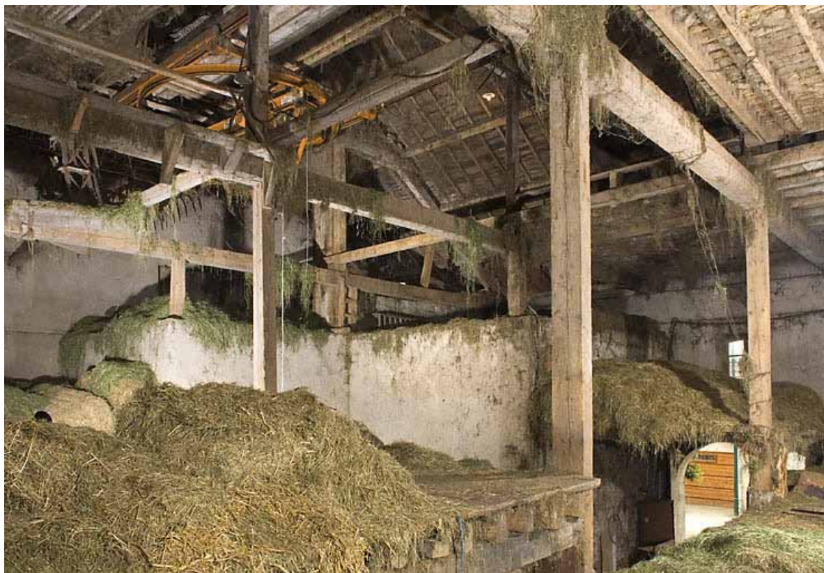
Ferme au 4 rue du Faubourg (2008 AB 47) : intérieur de la grange, à l'étage. 25, Jougne
