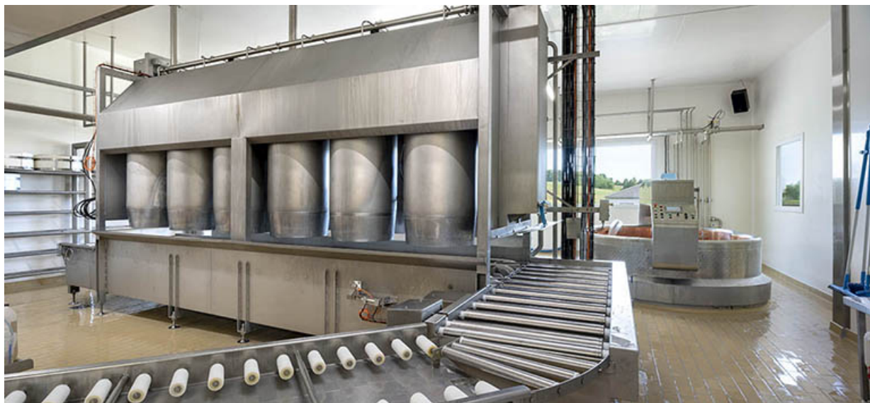
Atelier de fabrication : système de moulage.
