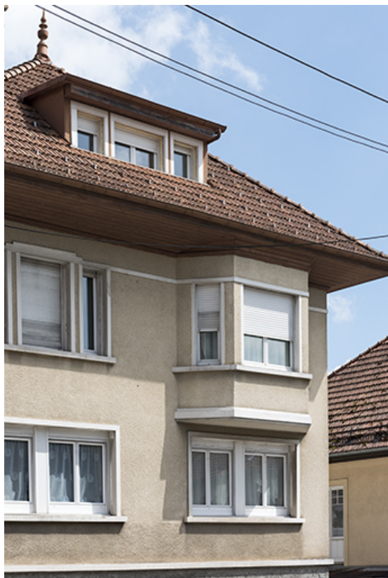
Façade antérieure : baies des étages et oriel. 25, Morteau, 20 rue de la Louhière
