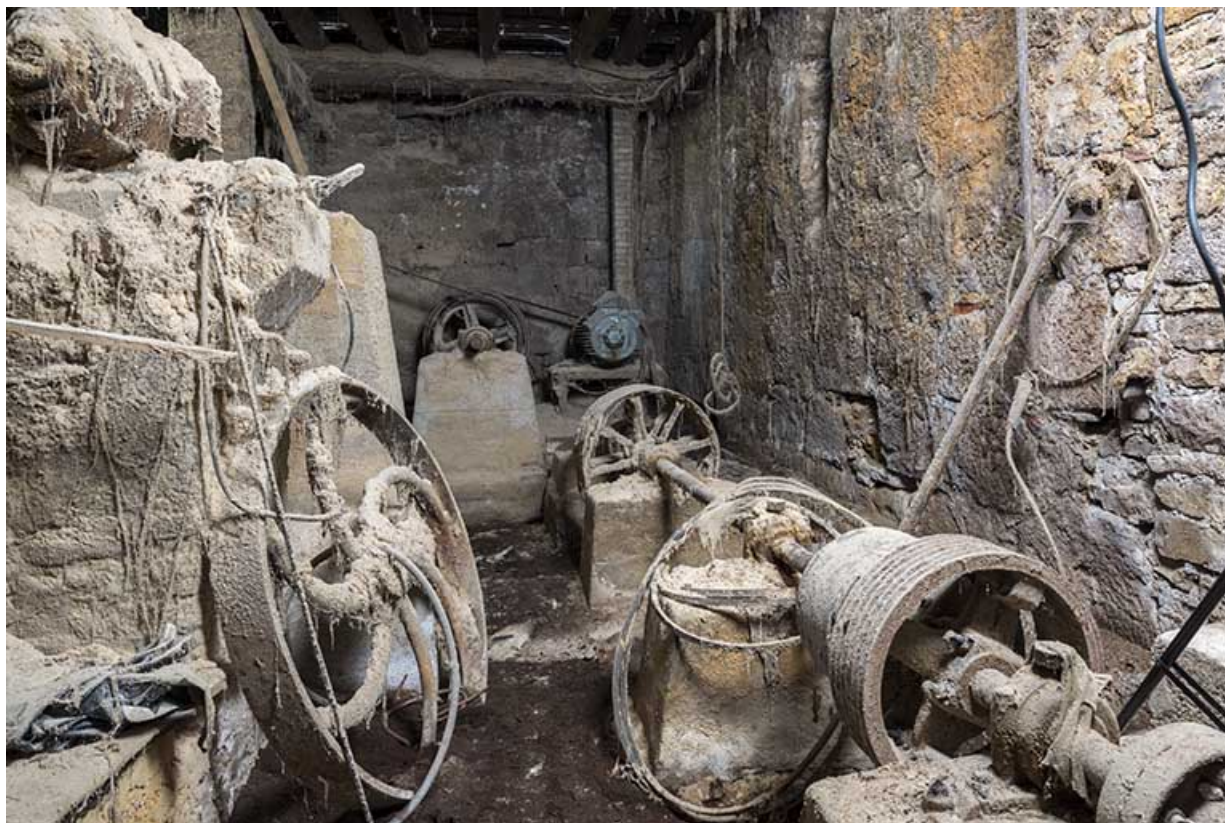
Atelier de fabrication, sciurier : transmission de la turbine.
