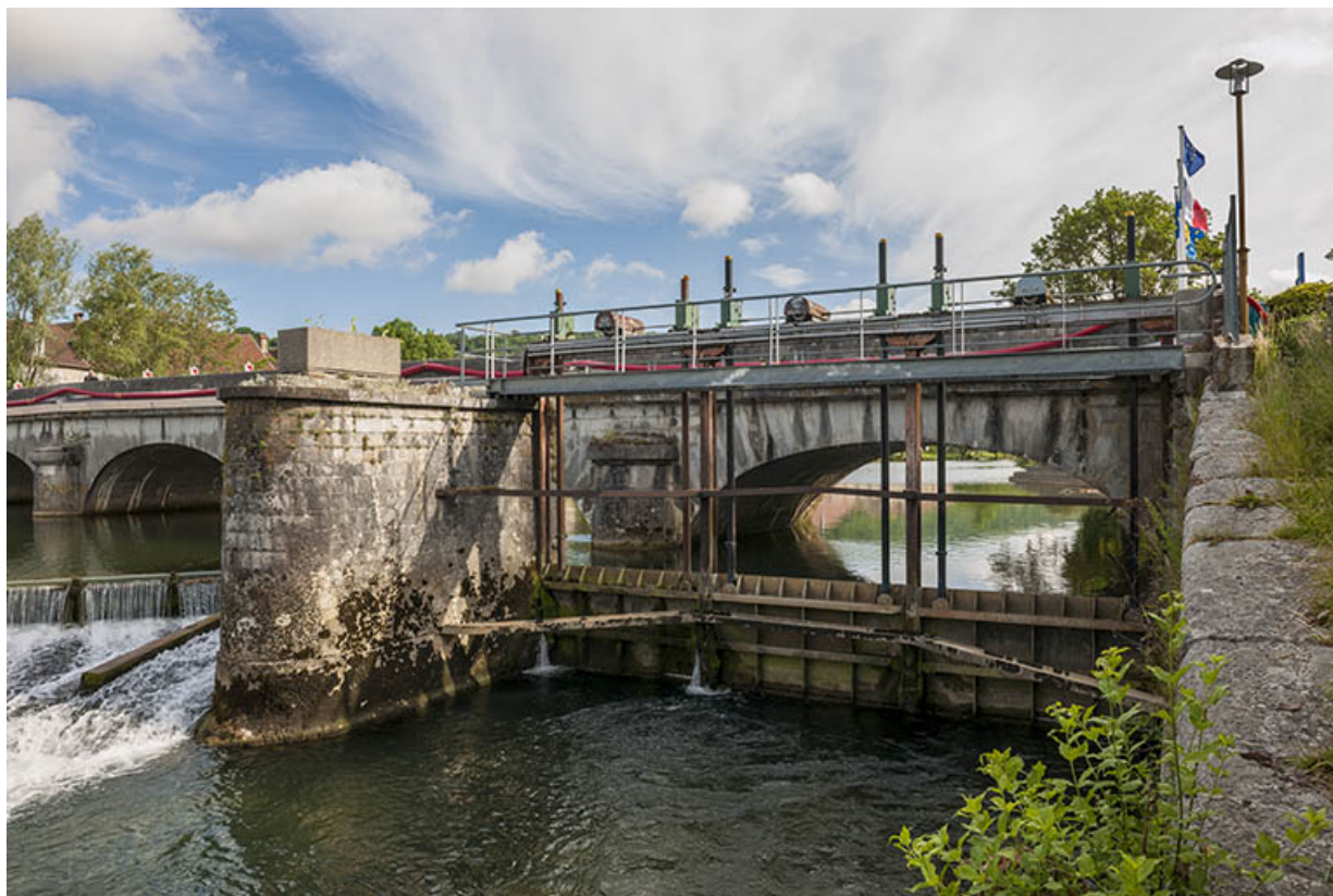
Vanne de décharge à l'extrémité nord du barrage.
