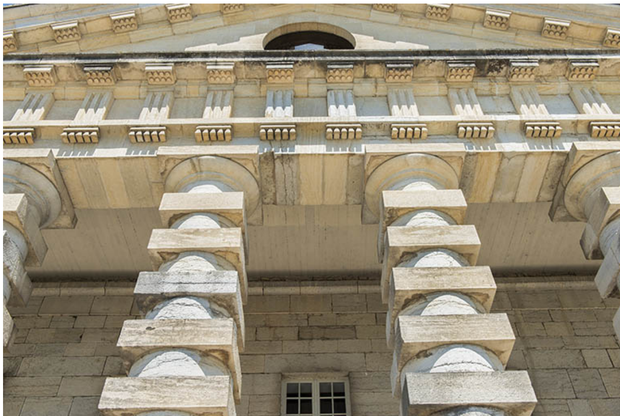
Maison du directeur. Détail de la partie supérieure du portique. 25, Arc-et-Senans Grande Rue
