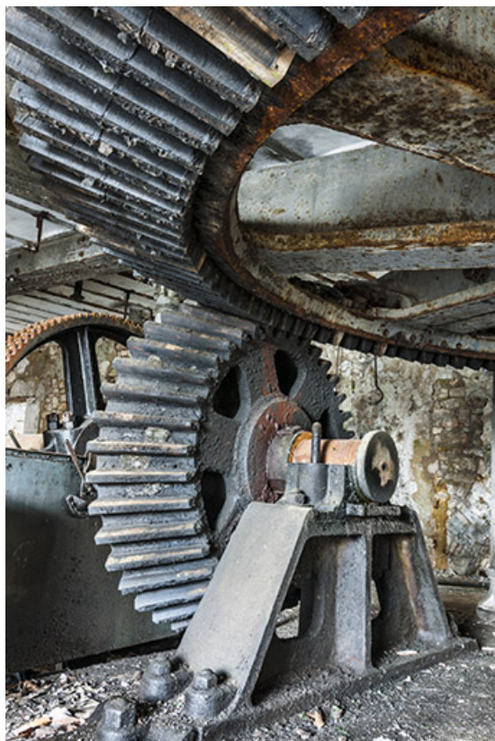
Rez-de-chaussée de l'atelier principal. Transmission par engrenages coniques de la turbine. 25, Geneuille route des Papetiers
