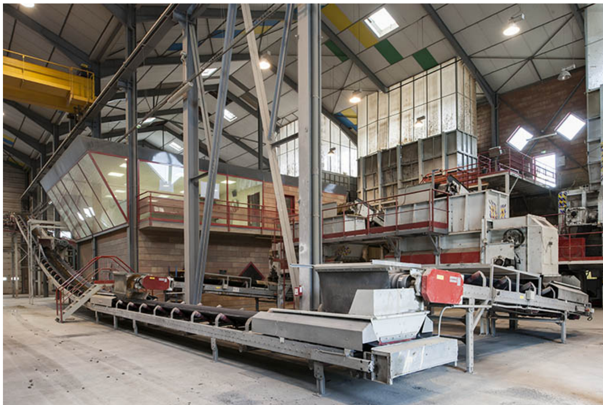
Atelier de préparation des terres. Vue d'ensemble (partie est). 25, Lantenne-Vertière route de Mercey
