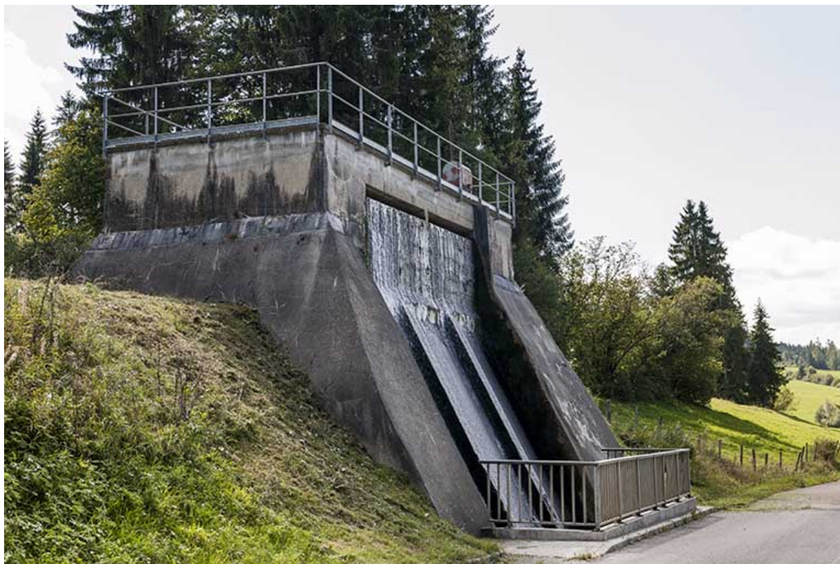
La chambre d'équilibre à l'aplomb de la centrale. 25, Labergement-Sainte-Marie, lieudit : le Fourpéret
