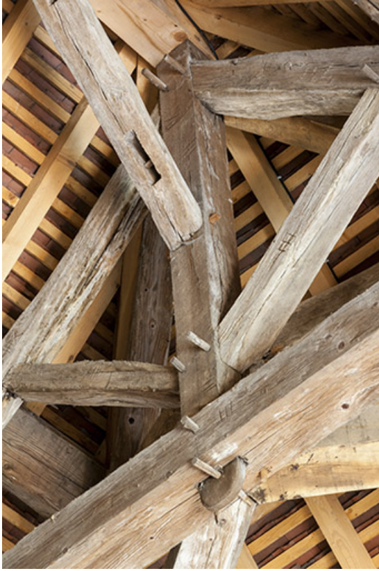
Assemblage de la ferme de la croupe. Détail. 25, Vaire-le-Petit chemin de Roche
