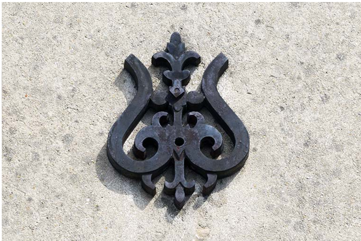
Minoterie : ancre de tirant sur la façade antérieure.
