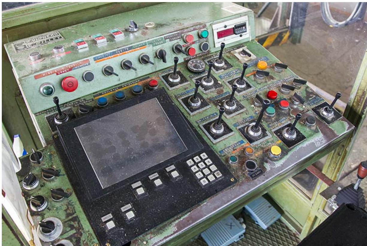
Atelier de fabrication de 1980-1982 : pupitre du poste de commande de la scie Gillet et Vigneau.
