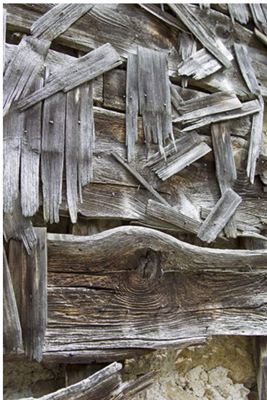
Façade postérieure : support de l'essentage de tavillons, avec quelques tavillons. 25, Charquemont, 48 Grande Rue
