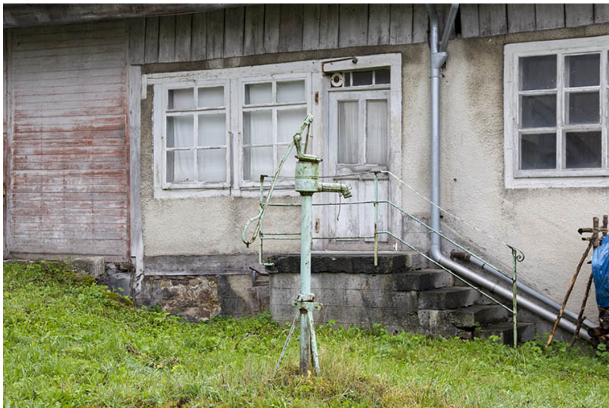
Façade latérale droite : entrée et pompe à eau. A gauche, la porte d'accès au fenil. 25, Charquemont, 9 Grande Rue
