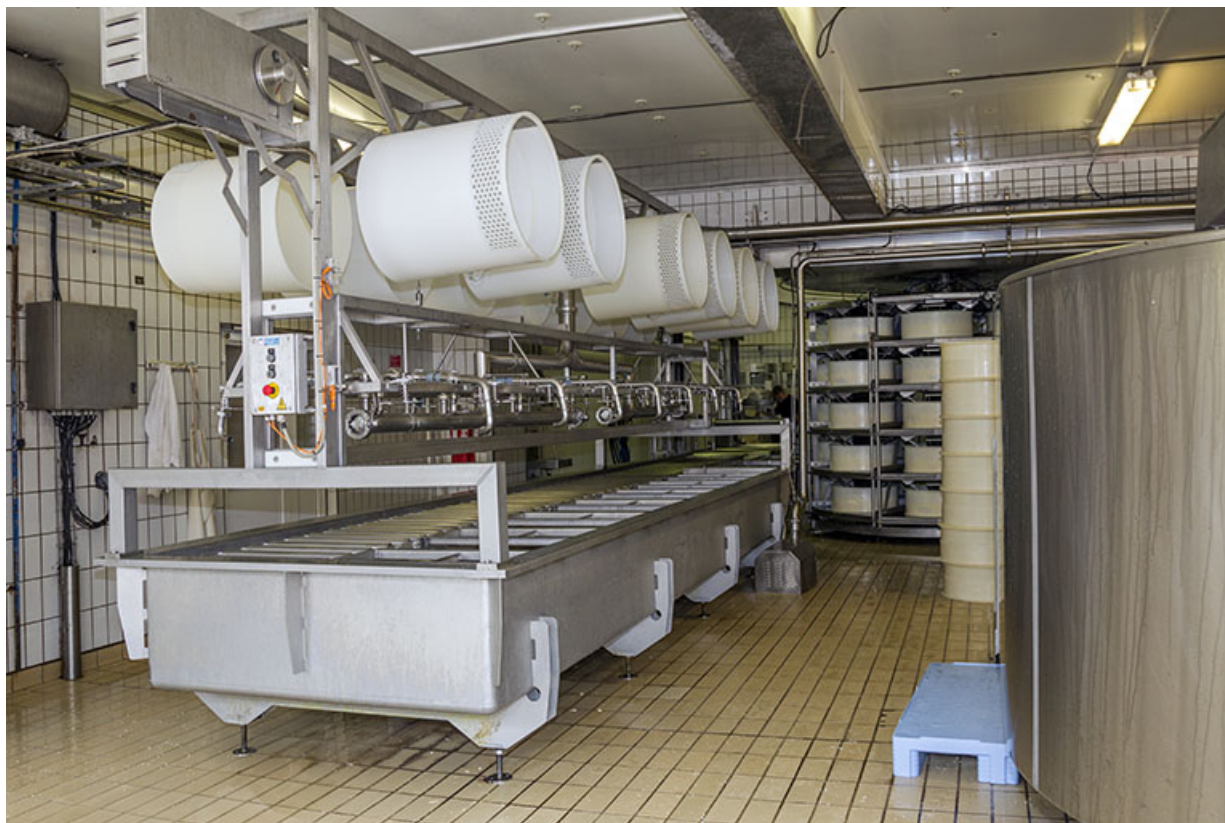
Installation de soutirage par pompe à caillé : le répartiteur. Les rehausses de moulage sont suspendues en partie haute du répartiteur.
