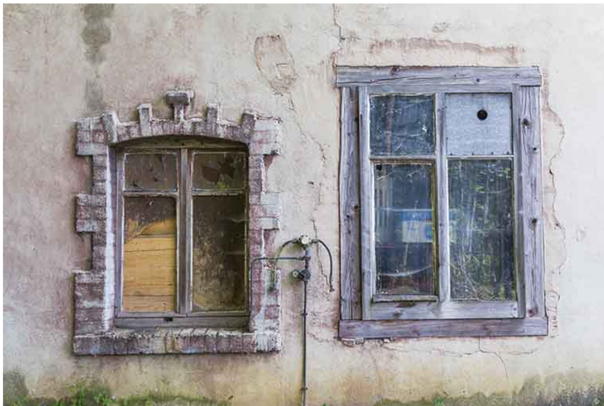
Atelier de fabrication occidental : deux baies au rez-de-chaussée de la façade postérieure.
