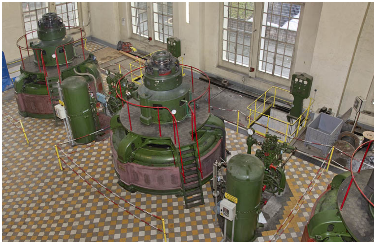
Centrale : vue plongeante sur les groupes n° 3 et 4. 25, Liebvillers, lieu dit : Moulin Artus
