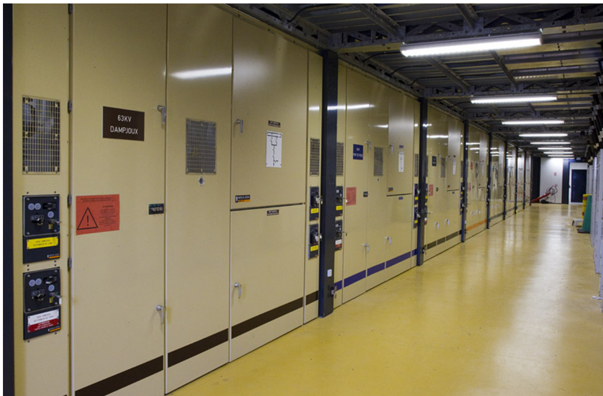
Transformateur RTE : intérieur. 25, Liebvillers, lieudit : Moulin Artus
