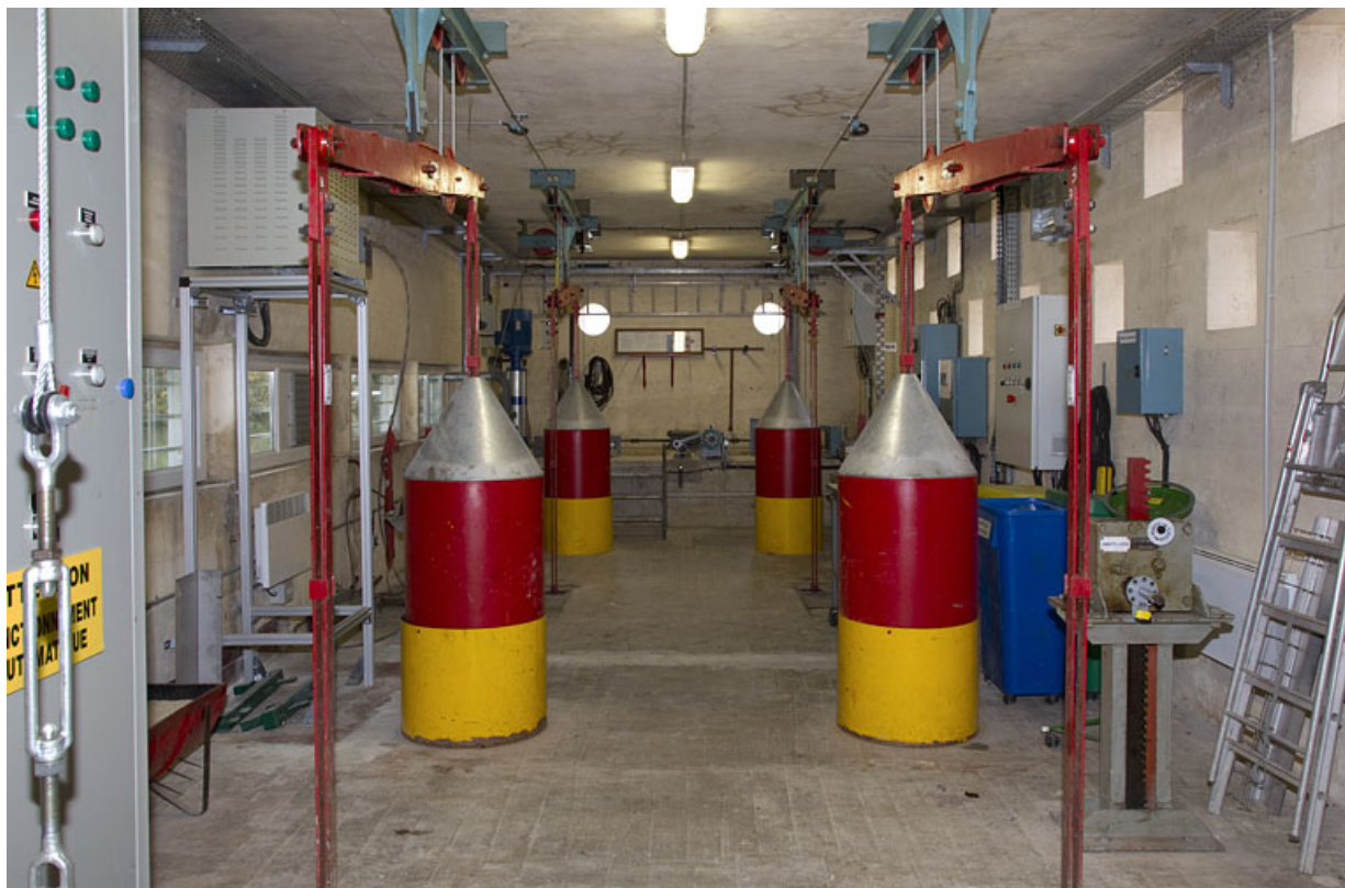
Barrage : intérieur de la salle de commande des vannes toit.
