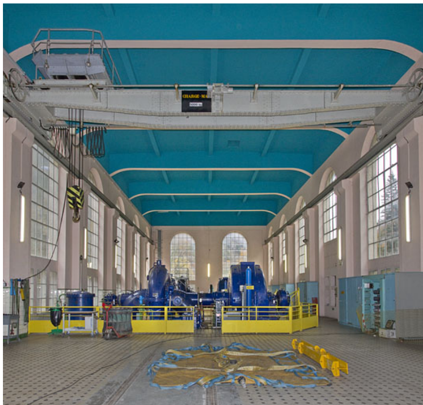
Centrale : intérieur de la salle des machines.
