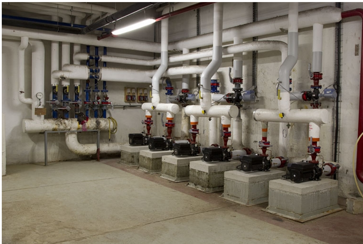
Bâtiment de l'internat ouest, chaufferie : les pompes.
