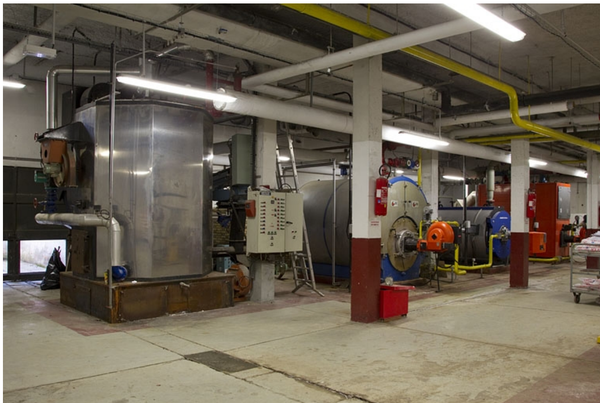
Bâtiment de l'internat ouest, chaufferie : les chaudières.
