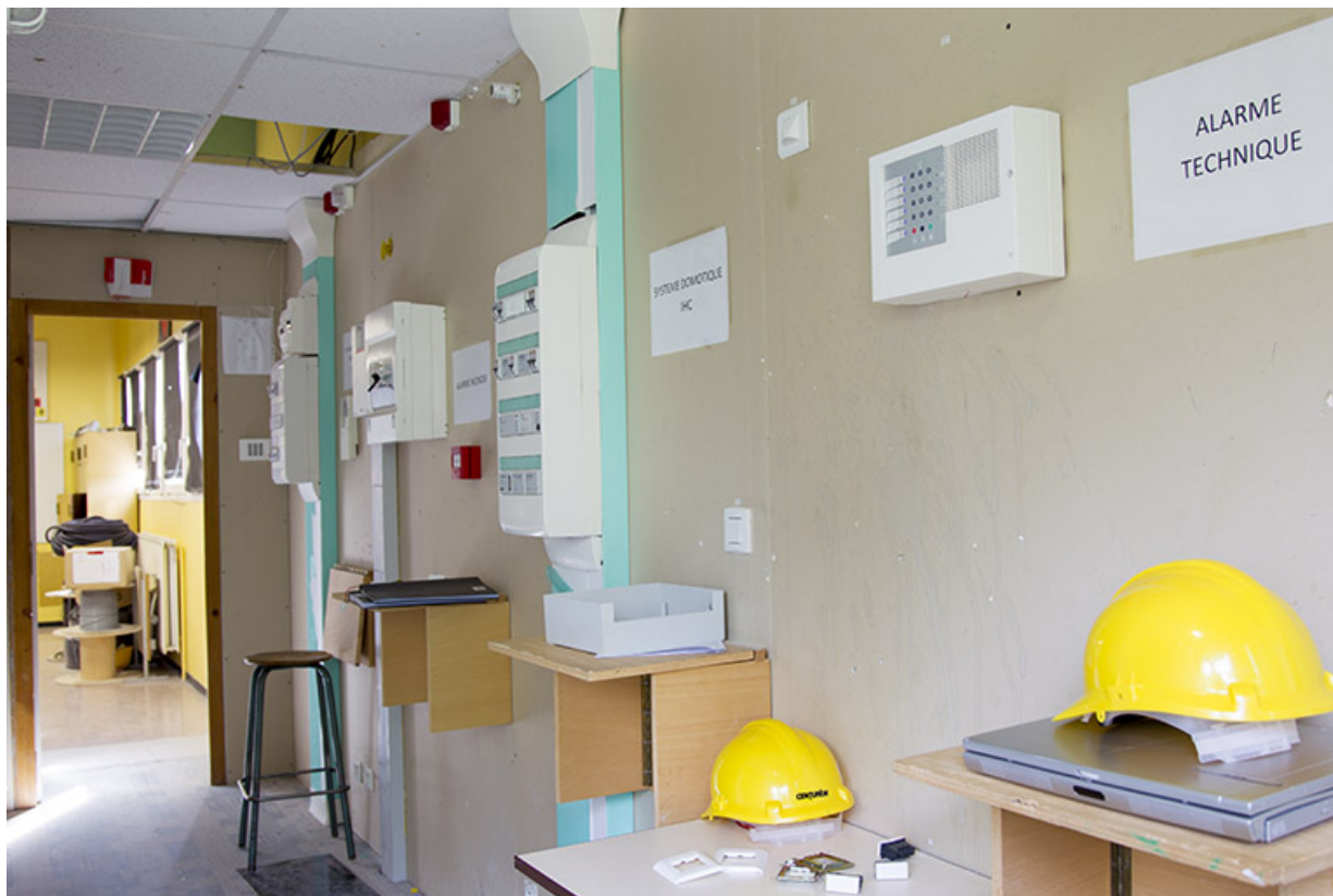
Intérieur de l'atelier des formations en électrotechnique.
