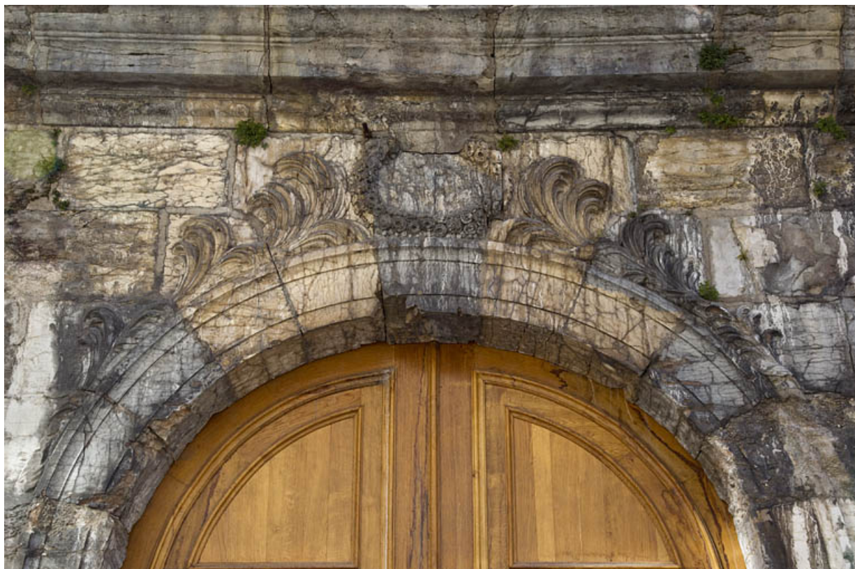
Détail de l'ancien portail du couvent des Cordeliers situé dans la rue du Lycée. 25, Besançon, 4 rue du Lycée
