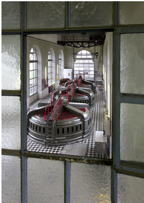
Vue plongeante sur la salle des machines.
