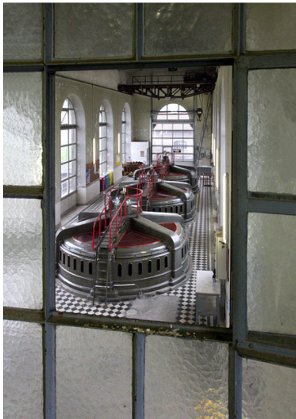
Vue plongeante sur la salle des machines.
