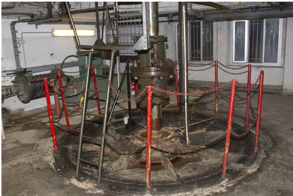
Partie supérieure d'une turbine et arbre de transmission vertical.
