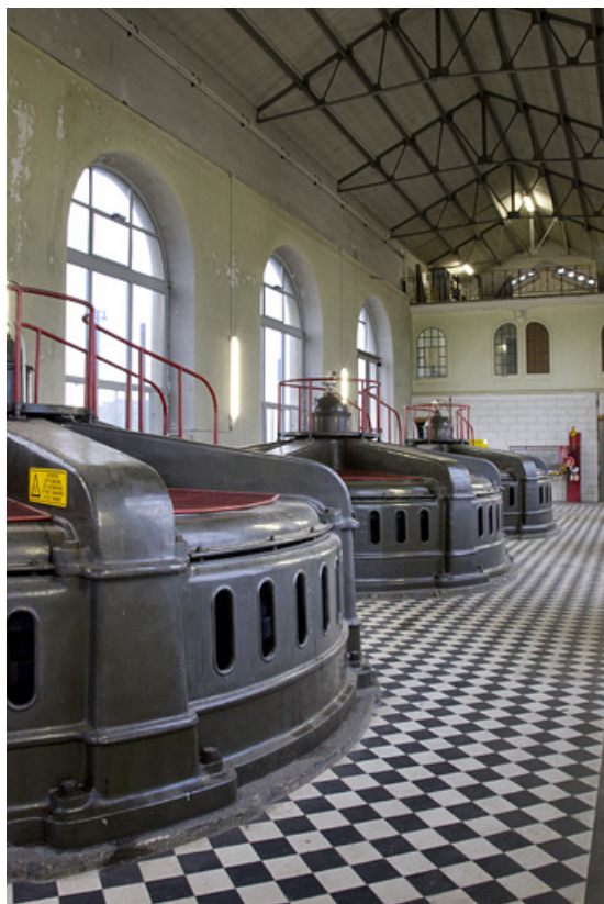
Alignement des groupes turbo-alternateurs dans la salle des machines.
