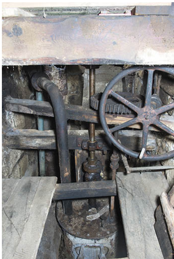
Mécanisme de débrayage de la turbine (visible en bas). 25, Rémondans-Vaivre, 14 rue du Moulin
